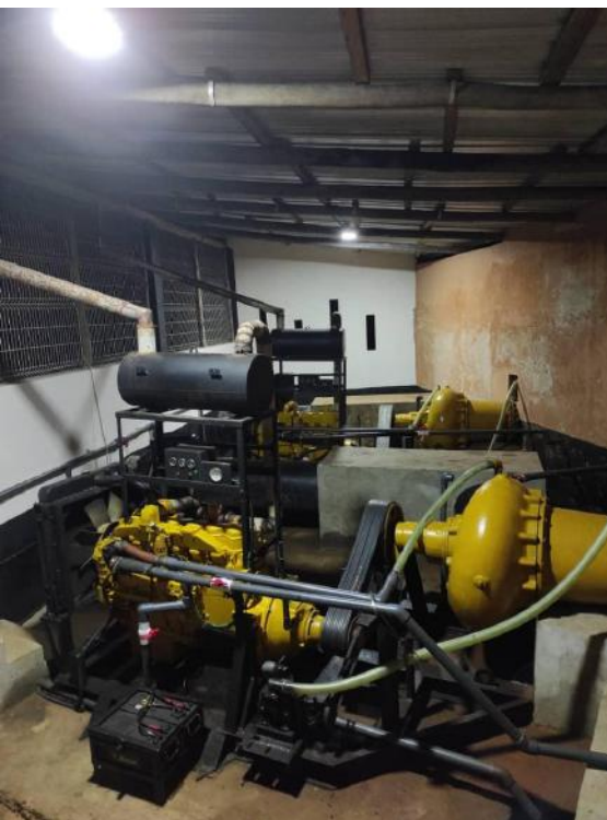
Estación de bombeo.
