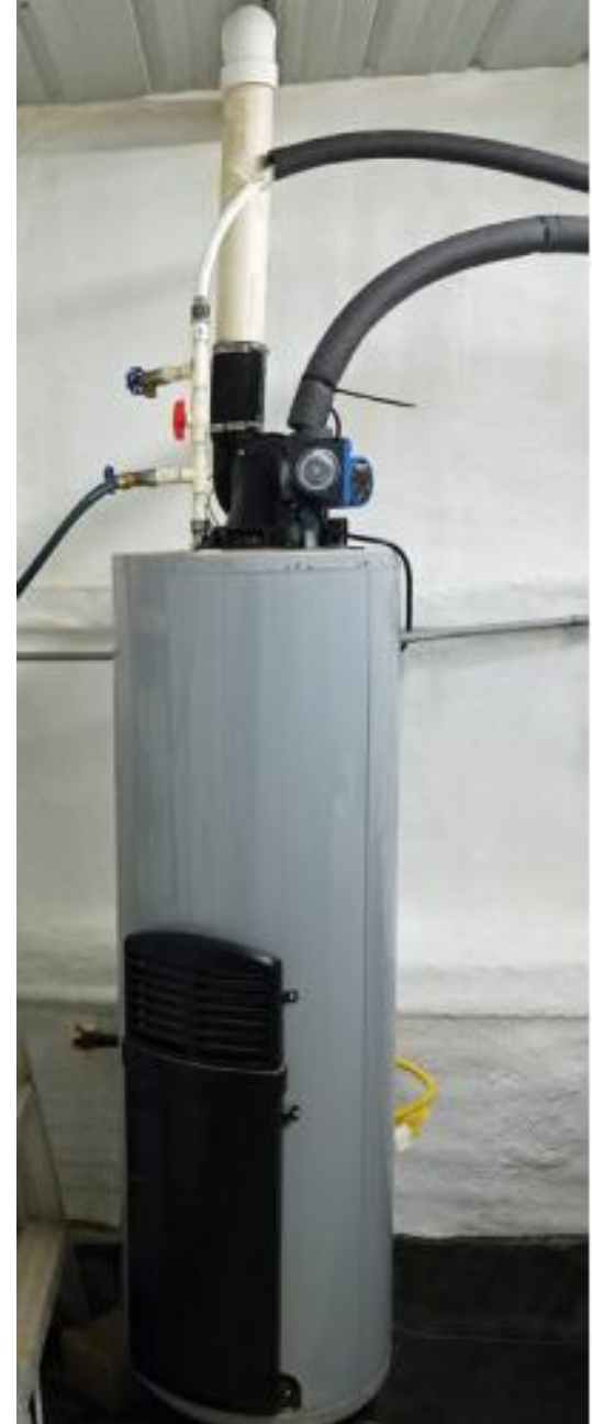
Figura 7. Calentador de agua con bomba de circulación y temporizador para ser operado por períodos de tiempo cada día. El agua viaja por las tuberías de polietileno (PEX) en cada tanque de producción y luego de regreso al calentador de agua.
